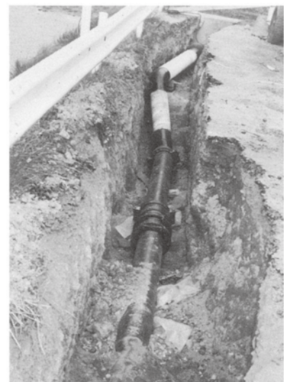
上水道配水管路
