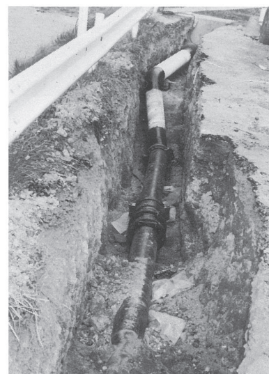
上水道配水管路
