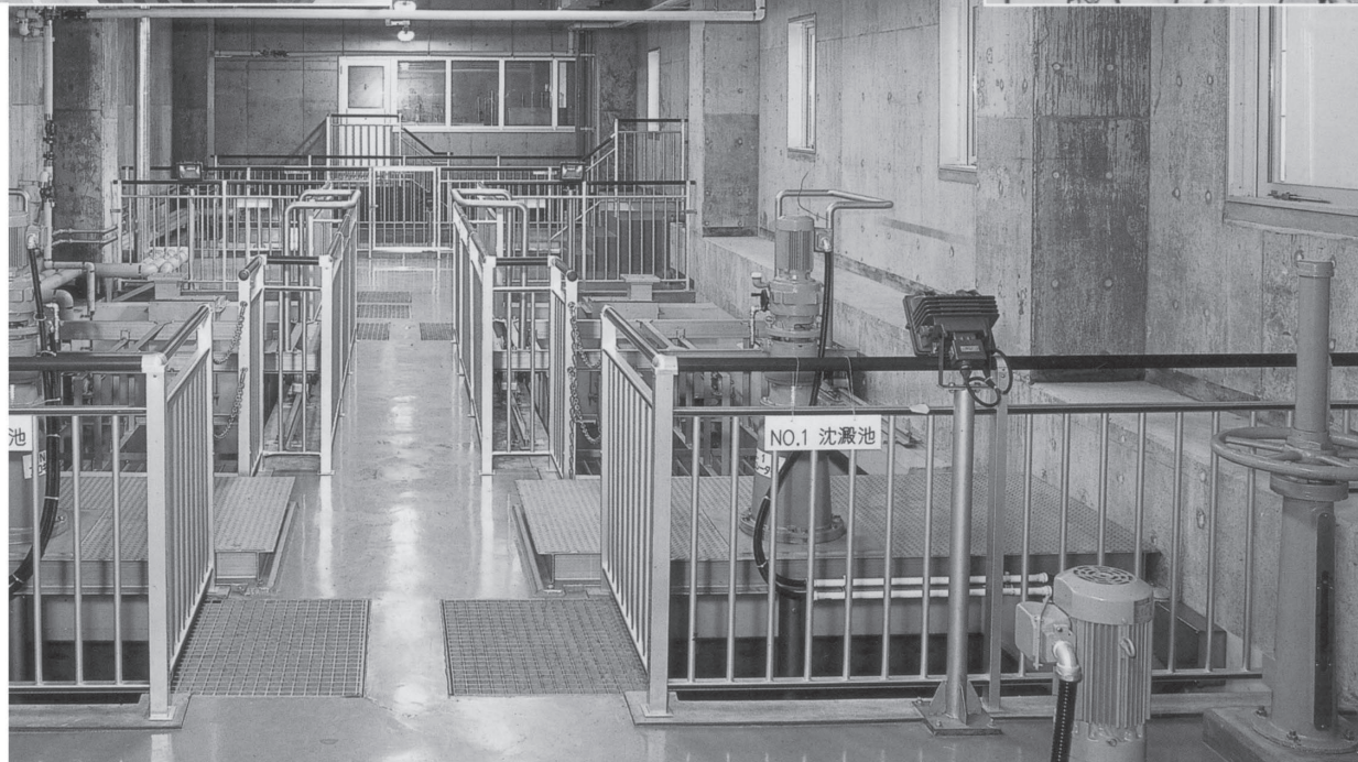
急速濾過設備
