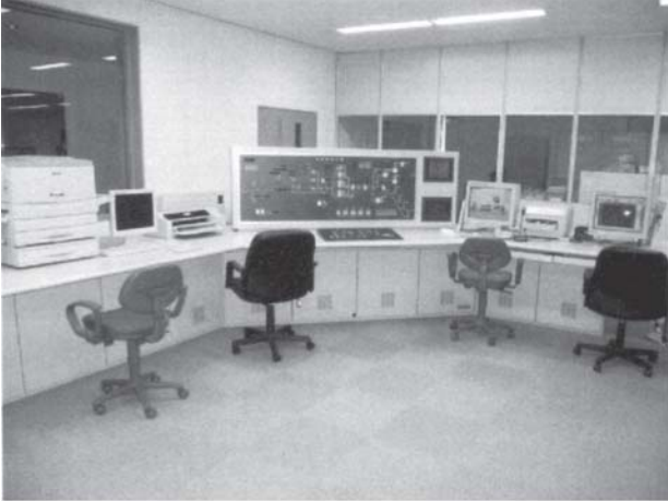
中央監視装置
