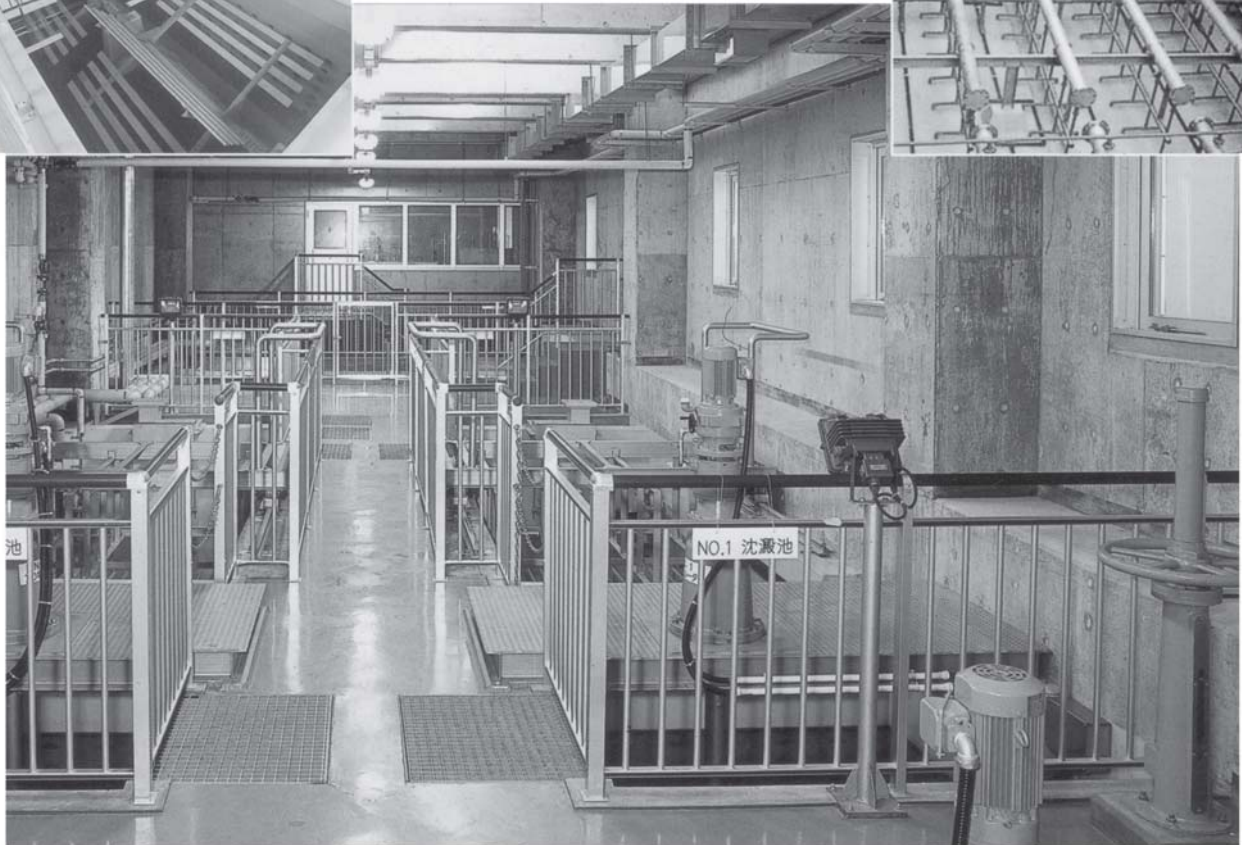
急速濾過設備
