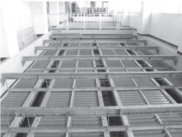
傾斜板沈殿池
