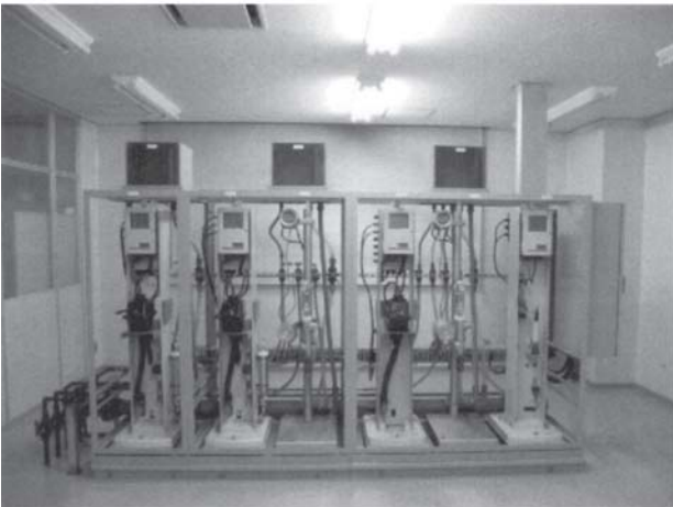
計装機器設備
