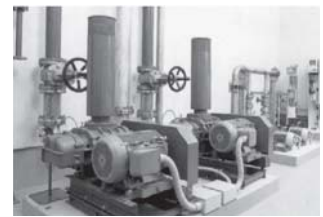
ポンプ・ブロウ設備
