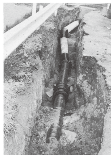
上水道配水管路
