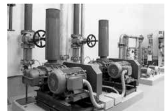
ポンプ・ブロウ設備
