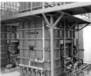
稼働中の浄水設備
