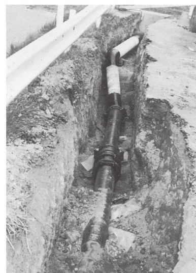
上水道配水管路
