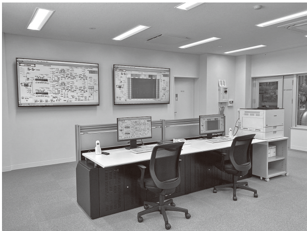
中央監視装置
