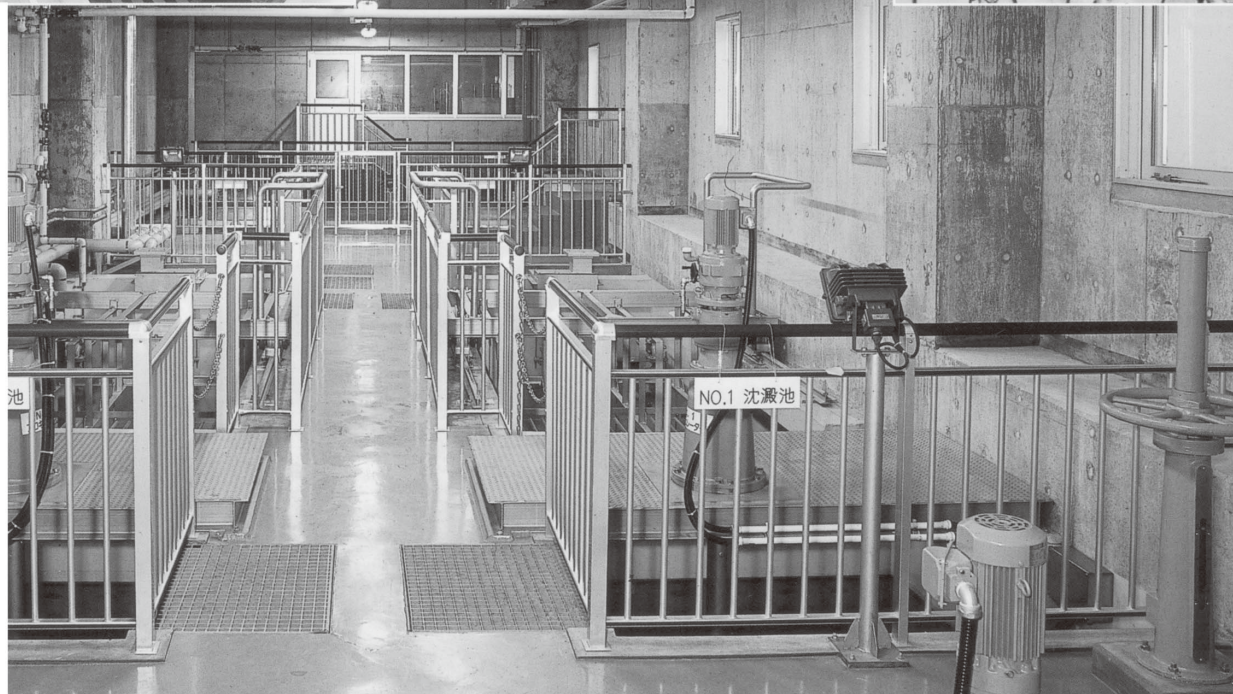
急速濾過設備
