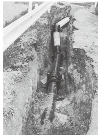
上水道配水管路
