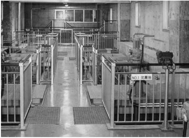
急速濾過設備
