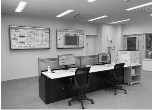
中央監視装置
