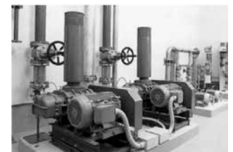
ポンプ・ブロウ設備
